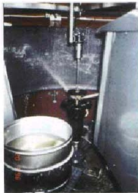
Figura 4: Torretta di installazione dell'irrigatore.
