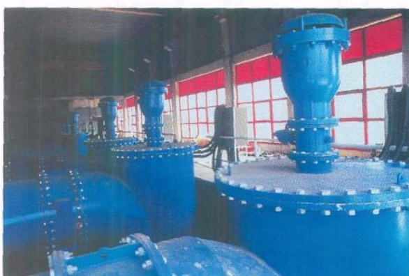
Figura 43. Sala de bombas.
