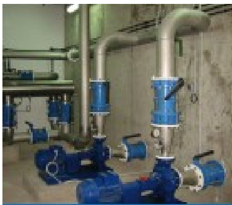
Estación de bombeo
