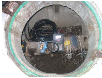
Figura 4. Mediciones en campo del caudal y la presión
