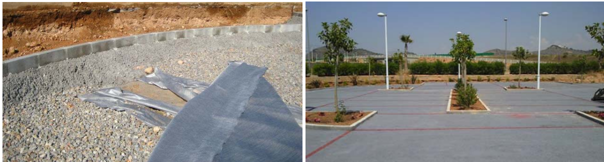
Figura 2 (a) Infraestructura en construcción: sub-base de gravas, dren y geotextil. (b) Infraestructura terminada.
