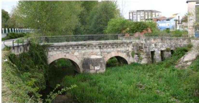
Figura 2. Puente "Rúa da Estrela", perteneciente al Camino de Santiago, de gran valor histórico, pero con muy baja capacidad de desagüe
