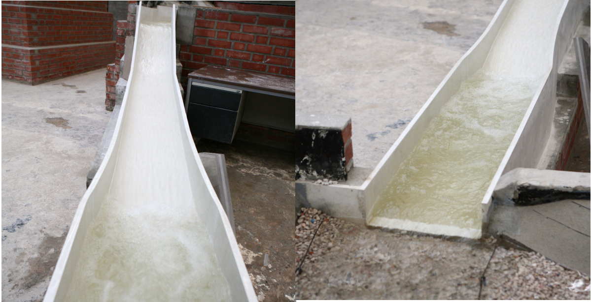
Figuras 3 y 4. Solución inicial. Q=150\text{ m}^3/\text{s} . C_e=773.16\text{ m.s.n.m} . Vista del canal de descarga y cuenco de amortiguamiento.
